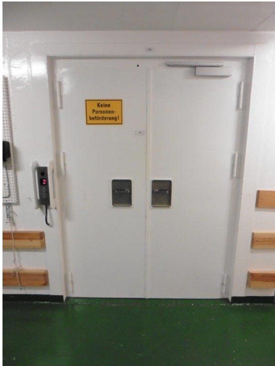
Lastenaufzug (Hauptdeckebene) geschlossen
