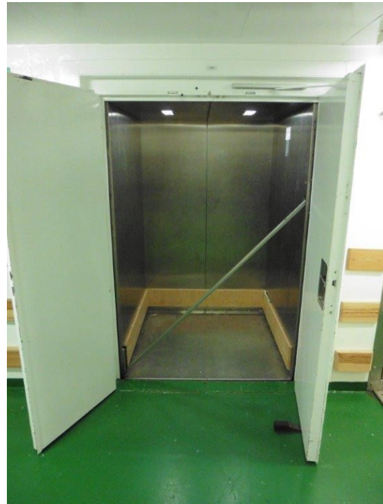
Lastenaufzug (Hauptdeckebene) geöffnet
